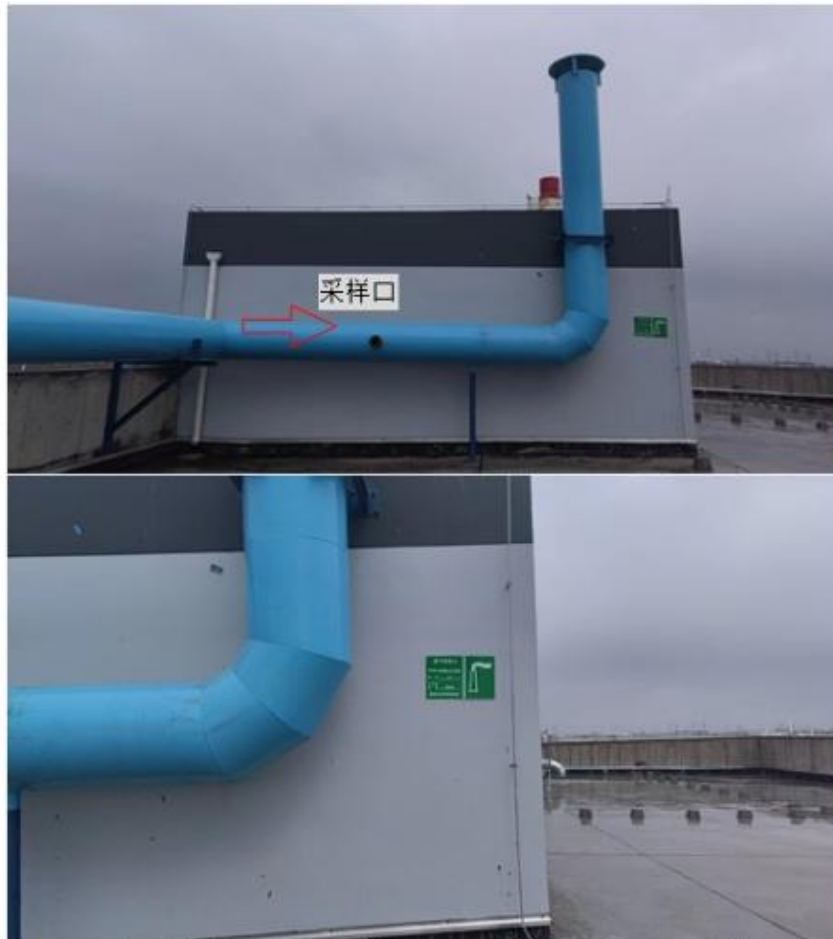
G4 银催化剂含尘废气排放口（采样口、标识）采样口
