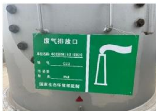
G23 罐区废气排放口（采样口、标识、标识牌）
