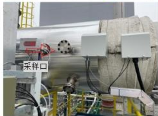
G3 银催化剂焙烧废气排放口（采样平台、标识）
