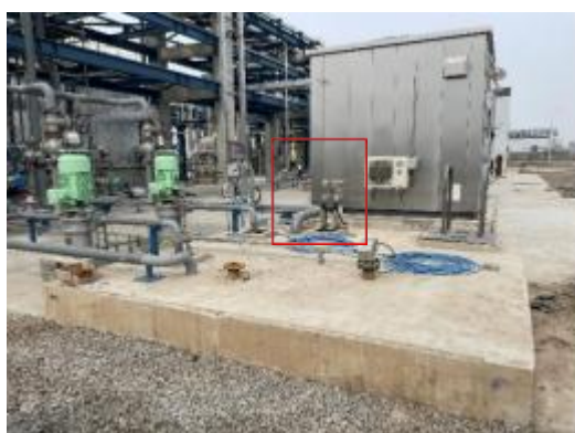
污水总排口 W2（DW002）在线监测室
