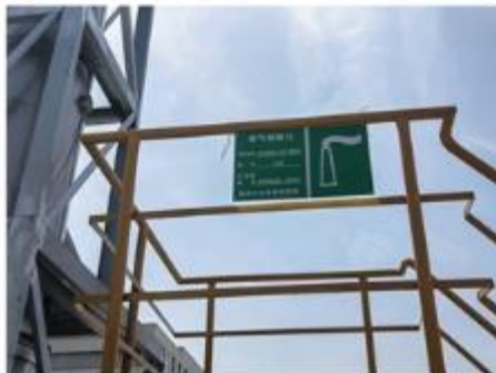
G28 中心化验室废气 3#（采样平台、采样口、标识牌）
