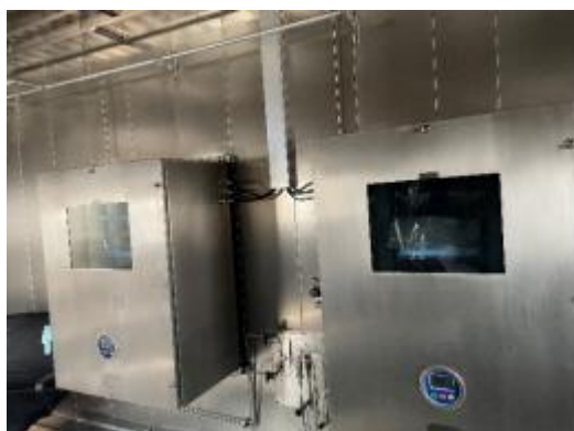
污水总排口 COD、氨氮在线监测
